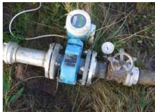
Billede 9. Prøvepumpning af boring med elektronisk vandmåler med direkte aflæsning af vandgennemstrømningen. Bemærk skydeventilen og manometeret.
