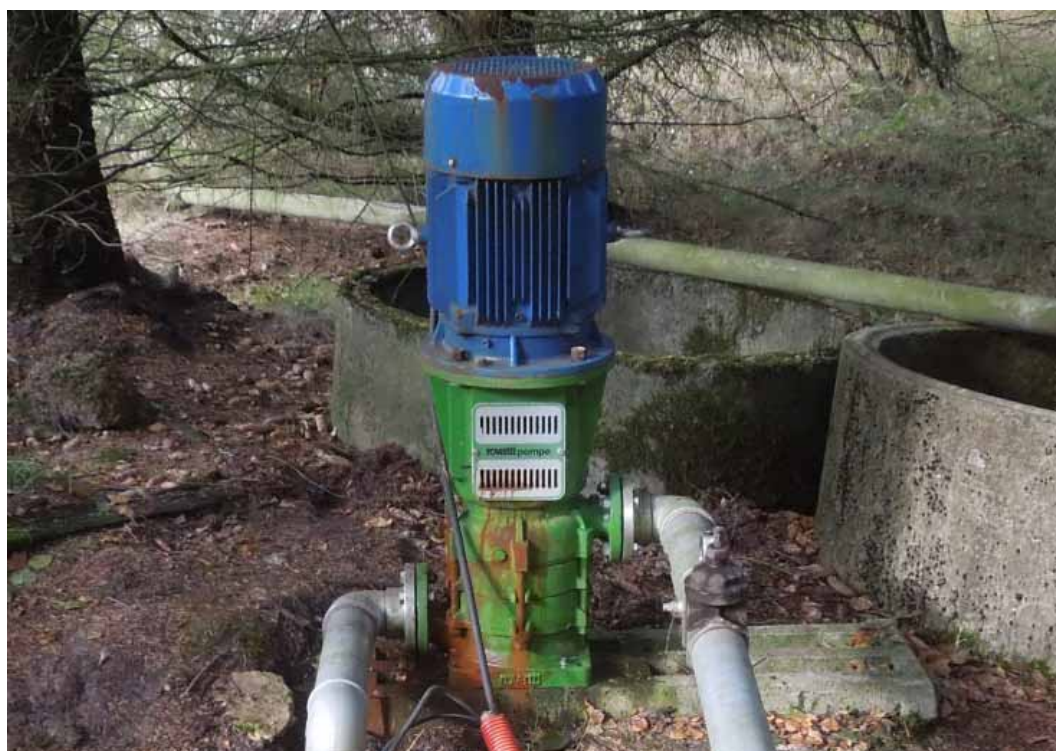
Billede 10. Trykforøgerpumpen er her placeret over jorden, uden beskyttelse for vejr og vind. Bemærk de tydelige okkerstriber, selvom pumpen kun er et år gammel.
